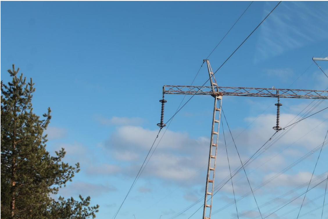
Sijainti 47/Kuva 105. Tie 22. https://goo.gl/maps/fWmEsTfctDZoxAko9 Fingrid-sähkölinja, 220 kV. Mitattu korkeus 11,40 m, kun lämpötila +1 celsiusastetta.
