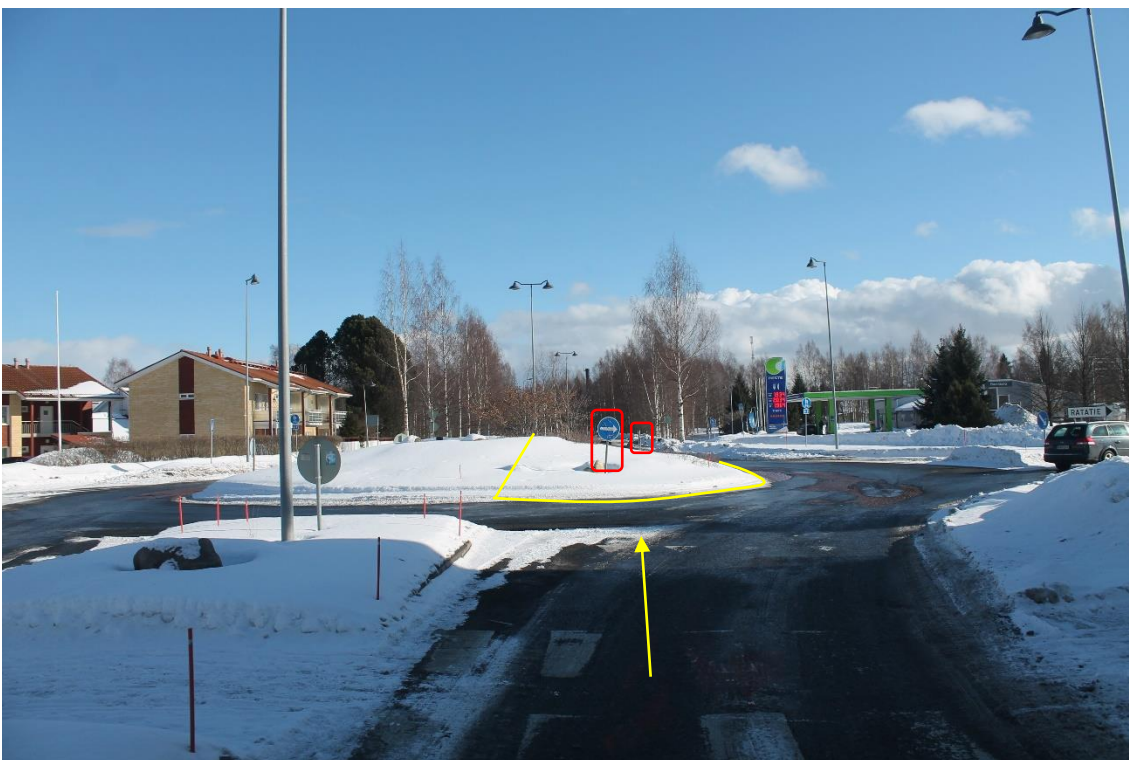
Sijainti 45/Kuva 100. Tie 22. Toinen liikenneympyrä. Merkitty alue tulee tasoittaa, jotta siitä voidaan ajaa. Merkityt liikennemerkkit poistettava.
