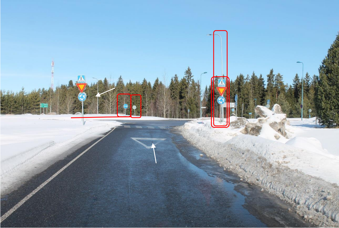
Sijainti 20/Kuva 41. Tien 4 ramppi: Ouluntulli. Korkeat lastit kuljetetaan liittymäramppien kautta. https://goo.gl/maps/vjM7atAyhSsGFUFW8 Merkityt lyhtypylväät ja liikennemerkit on poistettava. Liikenneympyrän sisäinen merkitty alue tulee tasoittaa ja tyhjentää sivuylityksen takia.
