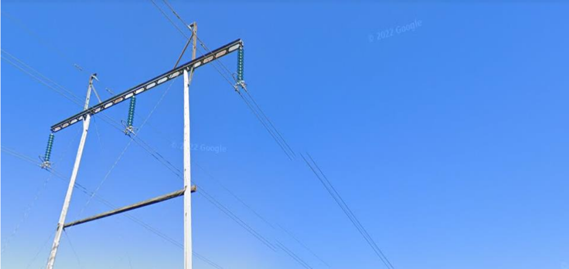
Sijainti 50/Kuva 109. Tie 22. https://goo.gl/maps/vK9WMgEBotmJkkj8 Fingrid-sähkölinja, 220 kV. Mitattu korkeus 11,10 m, kun lämpötila -5 celsiusastetta.
