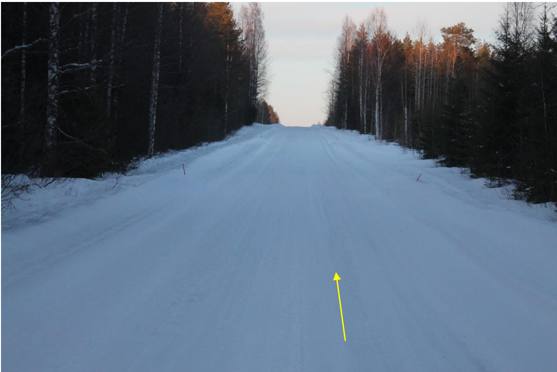
Sijainti 74/Kuva 142. Tie 8832 (Puokiontie). https://goo.gl/maps/uq2REdWZ35836fnt9 Tien pinta epätasainen.
