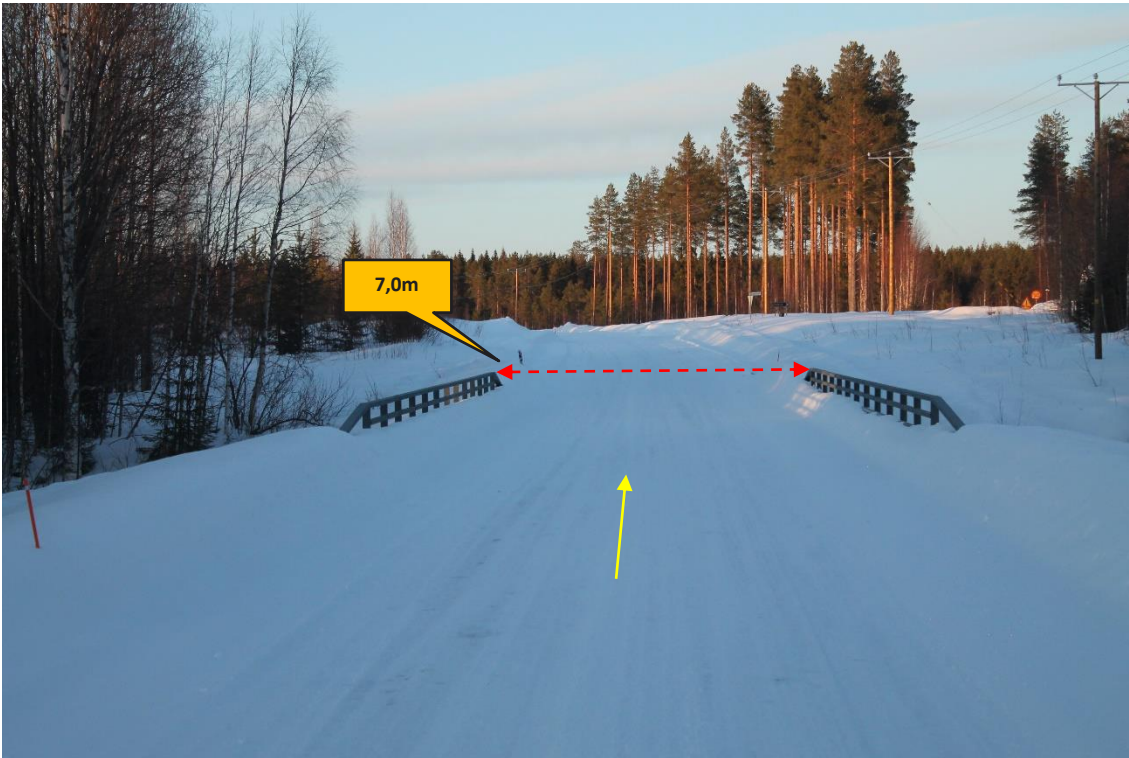
Sijainti 67/Kuva 135. Tie 8832 (Puokiontie). https://goo.gl/maps/PwDEyj28VFEXcn2L7 Sillan kantokapasiteetti tarkistettava.
