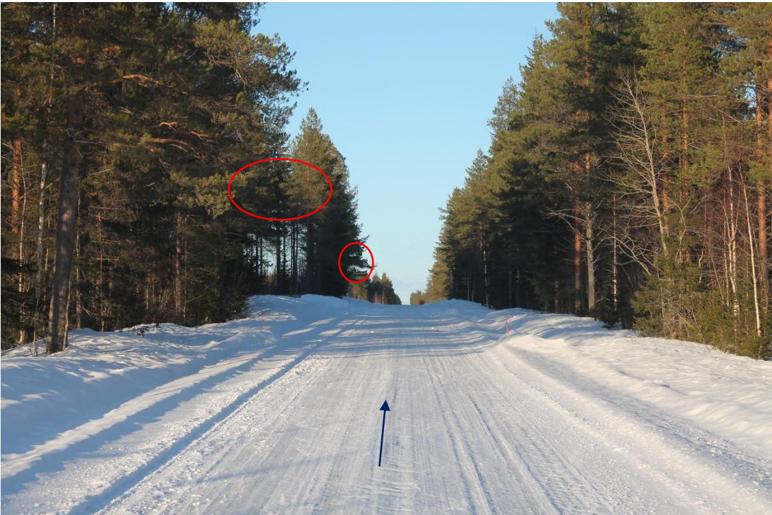
Sijainti 58/Kuva 122. Tie 800. https://goo.gl/maps/oWyDNHShdgMHQbsp7 Kaikki tien yläpuoliset oksat leikattava.
