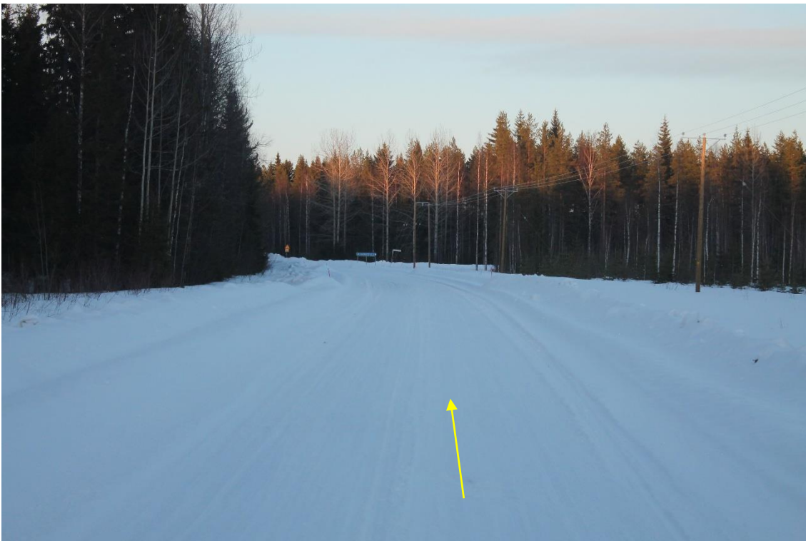
Sijainti 72/Kuva 140. Tie 8832 (Puokiontie). https://goo.gl/maps/XNR533Z8YqC43t4v7 Tien pinta epätasainen.
