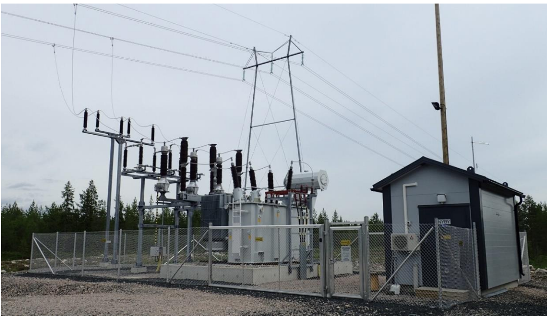
Kuva 5.8. Esimerkki tuulivoimapuiston sähköasemasta (Minna Takalo, FCG).
