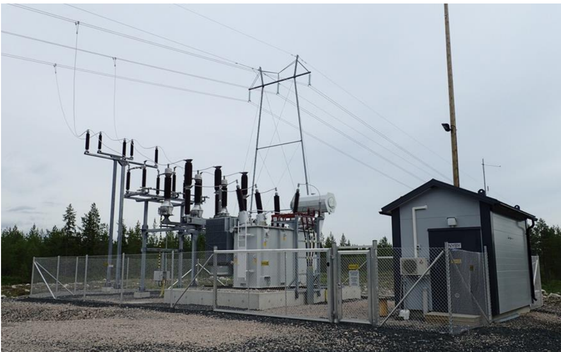
Kuva 71. Esimerkki tuulivoimapuiston sähköasemasta (kuva Minna Takalo/FCG).
